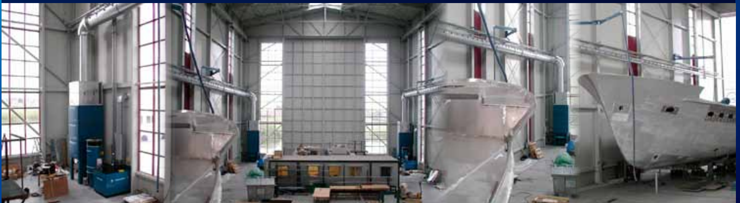
centrale hoogvacuüm stofzuiginstallatie
