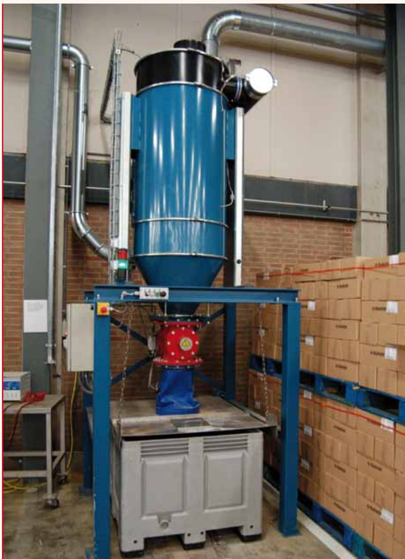
Automatisch gereinigd hoog-vacuüm-filtersysteem; lossing in grijze container. Links de aanzuigbuis, rechtsboven de aansluiting van de vacuümunit
